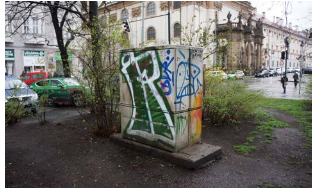
Prvky technické infrastruktury nevhodně umístěné v obvodovém valu
