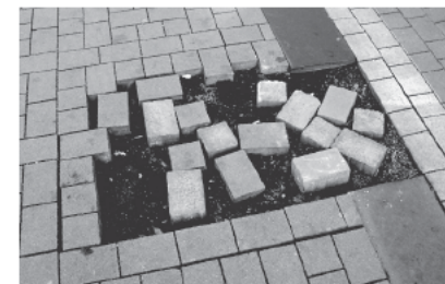
Neudržiavaná zámková dlažba
