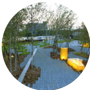
strácajúca sa dlažba
