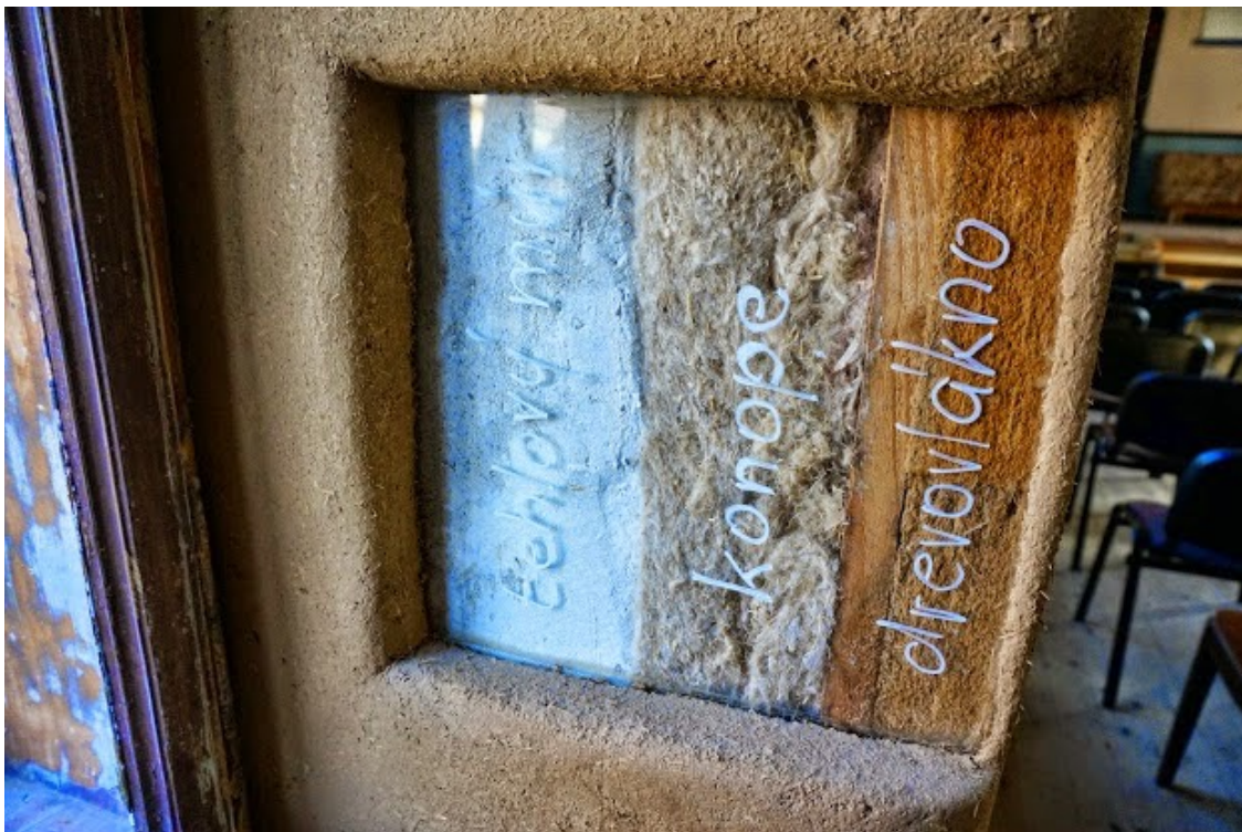
Obr. 19: Detail steny s presklením, stena je zateplená mäkkou konopnou izoláciou s drevovláknitým záklopom a vrstvou hlinenej omietky. (zdroj: OZ Artur)
