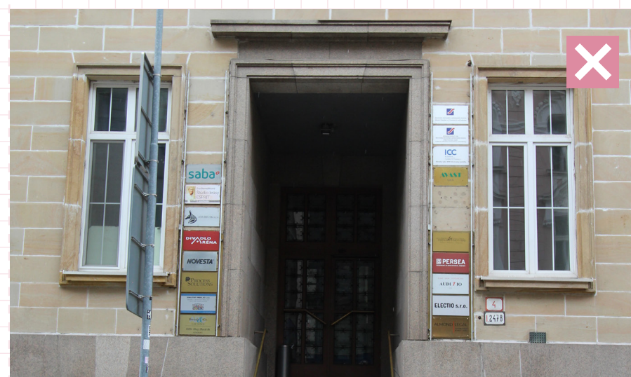
19 Príklad nevhodnej praxe. Tabuľky označujúce prevádzky umiestnené v budove sú rôznych farieb, materiálov a majú rôznu typológiu písma, čo pôsobí na fasáde rušivo. Bratislava, Májkova ulica
