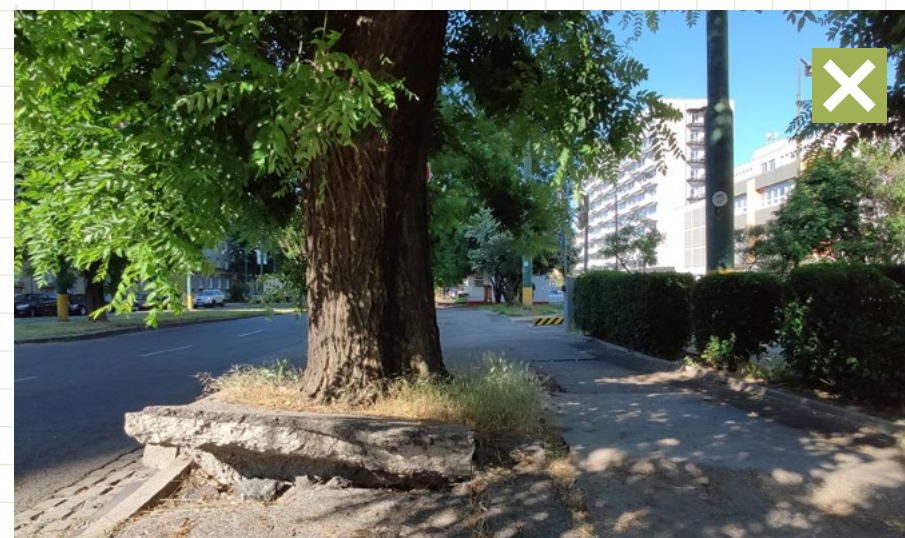
71 Dôsledok zle založenej výsadby - poškodenie komunikácie. Bratislava, Trenčianska ulica
