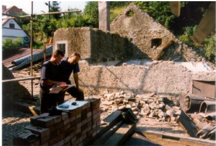
Odstránený krov po havárii. Stav v 1997.
