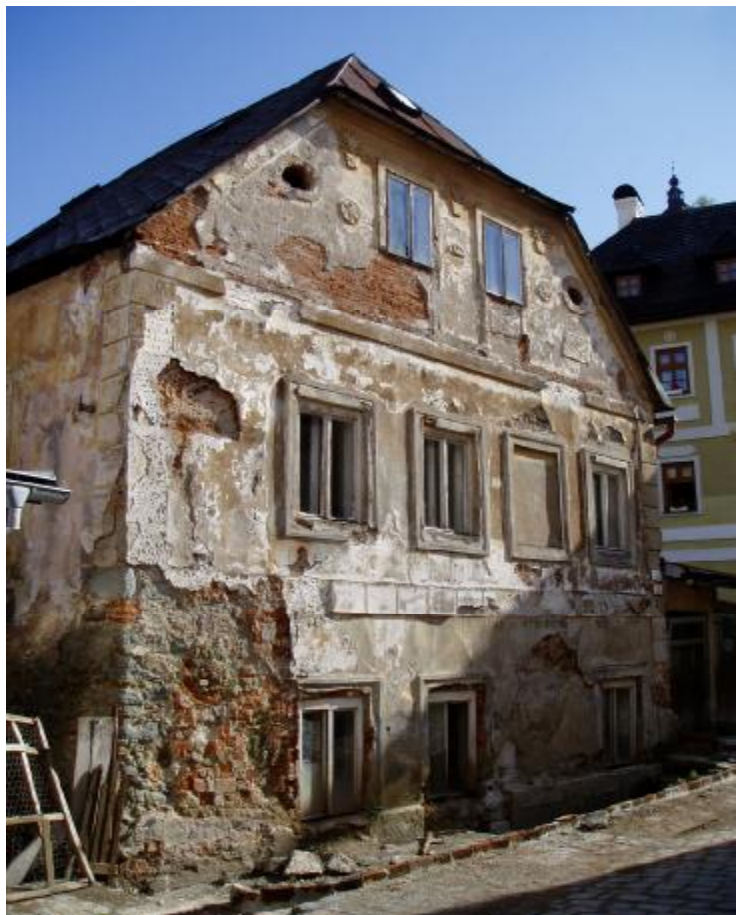
Stav domu pred obnovou (r. 2006), pohľad zhora na nárožie domu a dvor, v zadnej časti padnutá, provízórne prekrytá strecha. Na fotke dole: Stav uličnej fasády domu pred obnovou.
