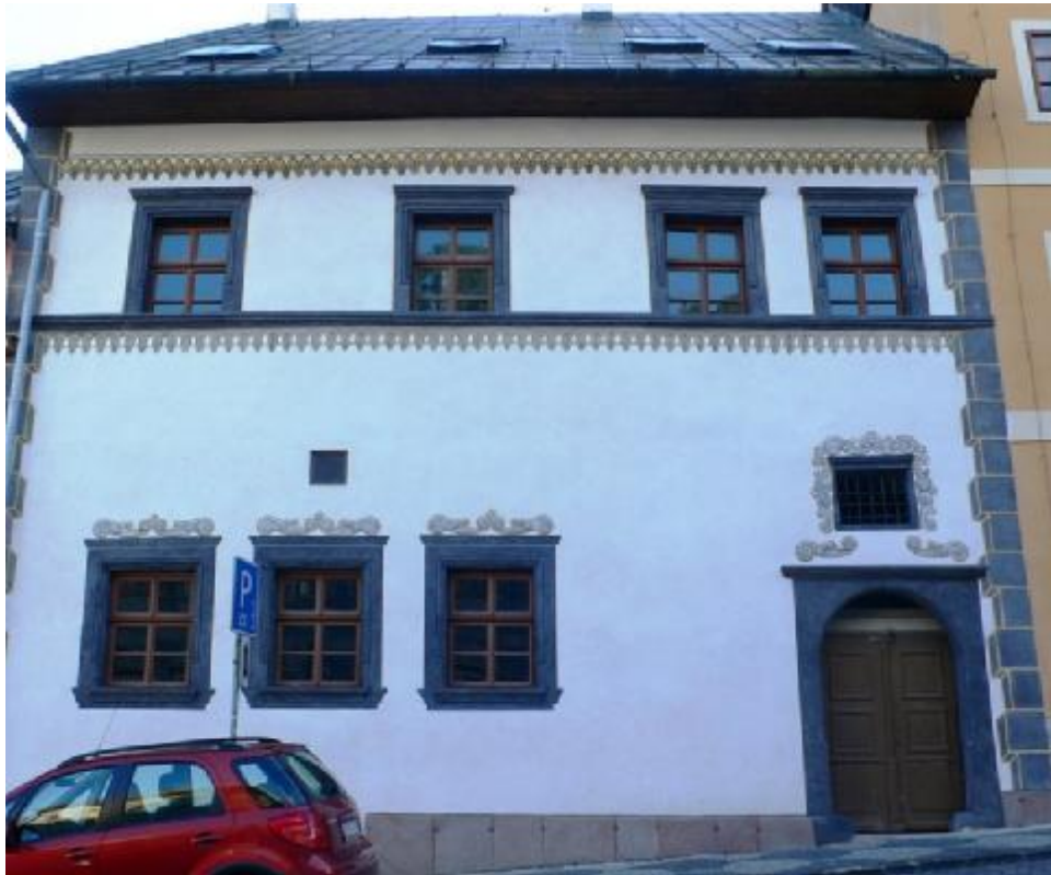
Rekonštrukcia renesančnej podoby fasády bez zachovania pôvodných kultúrnych omietkových vrstiev, vrátane rekonštruovanej renesančnej vrstvy.
