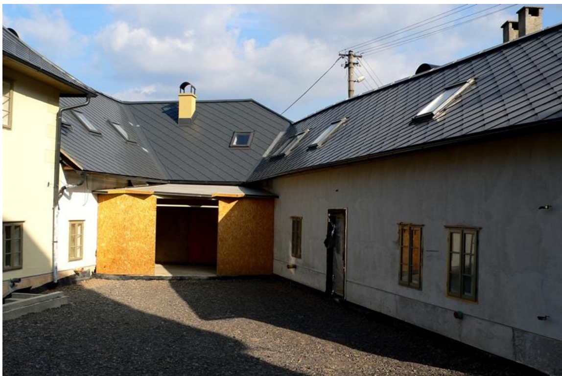
Pohľad do dvora po obnove. Narušená je strešná rovina na jednotlivých krídlach domu, náhodne umiestnené strešné okná a ich pôsobenie v rámci hmotovo nízkej časti domu značne narúša autenticitu pamiatky. Nevhodne sú riešené tvary hlavíc komínov. Celkový spirit je nulový.
