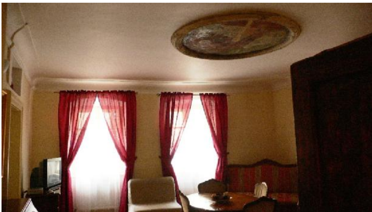
Miestnosť na prízemí s barokovou fabiónovou rímsou a so štukovou rozetou na plafóne. Omietky boli zachované, bola odhalená pôvodná maľba v štukovej rozete (zatiaľ nereštaurovaná retušami, len konzervovaná).
