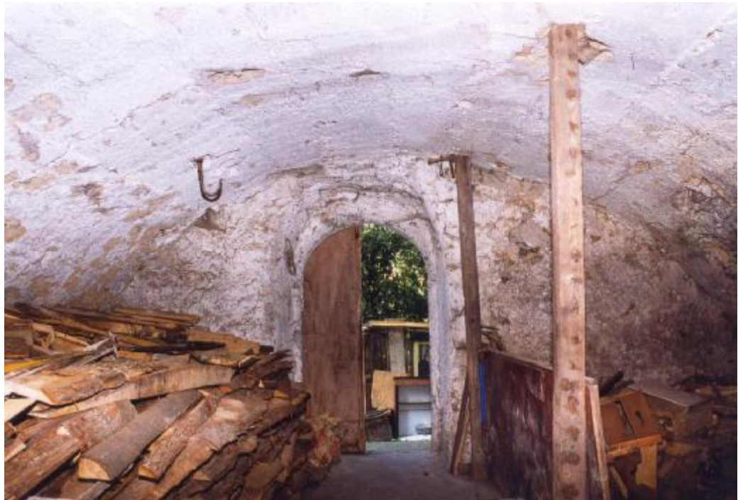
Pohľad do priestoru suterénu (zo strany dvora) s priamym vstupom z čelnej fasády. Priestor s valenou klenbou s kamenným oblúkovým portálom, s pôvodnými omietkami, resp. maltou vytlačenou pôvodne do debnenia klenby z doby vzniku konštrukcie klenby, stav v auguste 1998.
