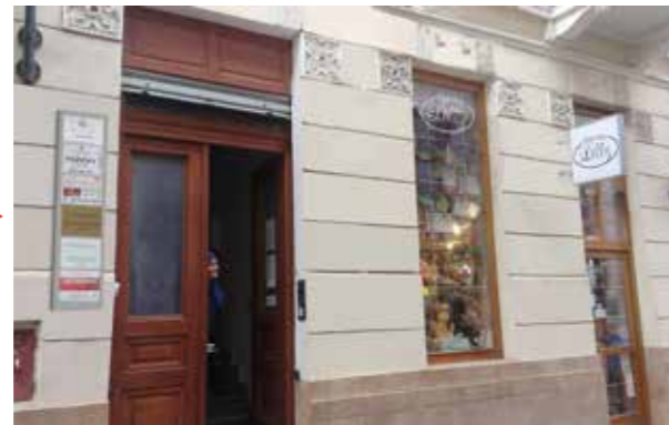
▲ 70. Návrh reklamy na tej istej fasáde podľa manuálu. Vzniklo jednotné označenie, odstránila sa duplicitná reklama.
