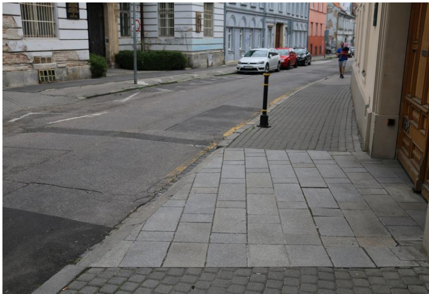
STAV POVRCHOVÝCH ÚPRAV NA PANENSKEJ ULICI RÔZNORODÁ NEKOODRINOVANÁ KOLÁŽ MATERIÁLOV
